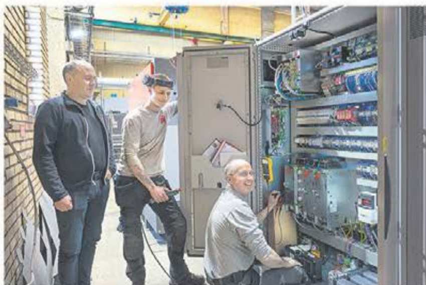
Anders Järnkrok övervakar installationen av laserskärmaskinen. Jens Karmebäck och Jan Exner har många kopplingar att hålla ordning på.
