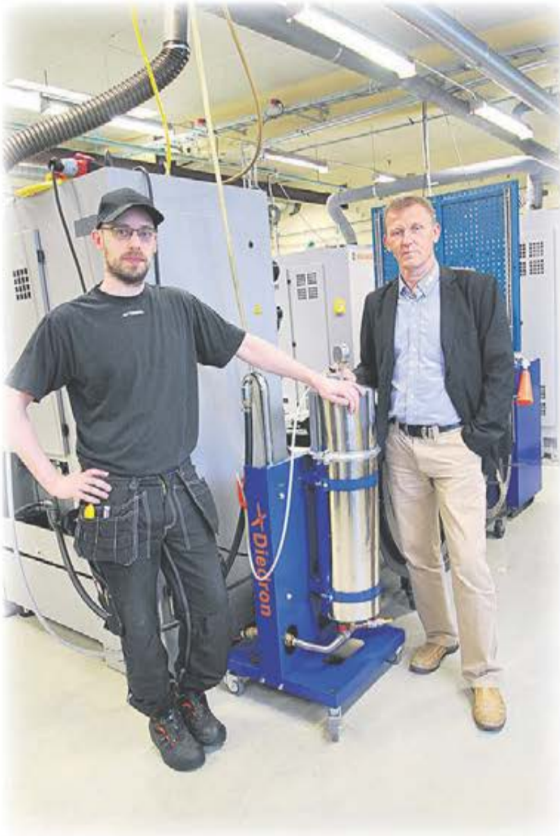
Mikael Bergh och Gustav Nyberg visar mobilt EFFE 2 med ett torn. Kapacitet 120 liter i minuten .. bypass, enkel att koppla in och fungerar utmärkt på mindre maskiner. Renar slipoljan direkt i maskintanken.
