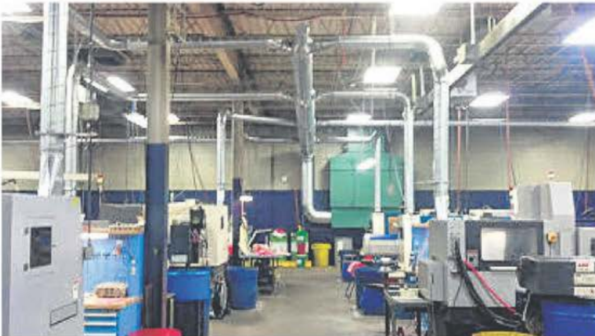
Rördragning i taket, en välkänd syn hos många verkstäder
