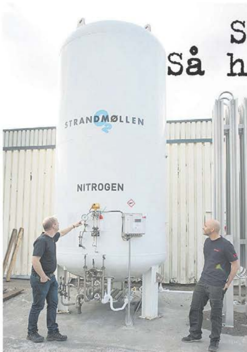
En nitrogentank har installerats för att kunna köra obemannat och kostnadseffektivt. Den kommer att säkerställa flödet till de båda laserskärama hos Femcab.
