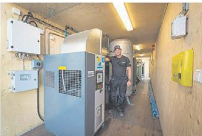
Vätgasgenerator står i en 12-meters container utanför verkstaden och levererar dygnet runt berättar Tomas Nilsson.
