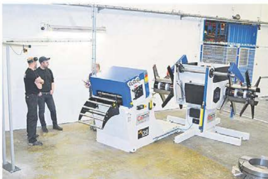
Daniel Axelsson från KM Safety, som kontrollerar att anläggningen uppfyller alla krav, i samråd med elektrikern Anders Englund från Sandins El och One Automations servicetekniker Tobias Pode.
